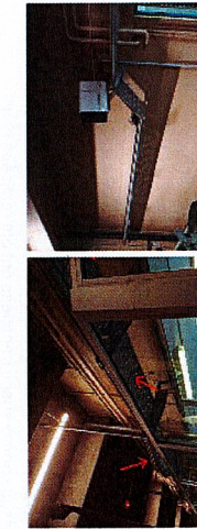
Chemins de câbles
