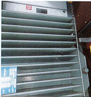
Impacts tirs d'arme à feu sur transformateur
