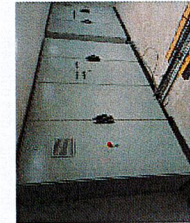
Nouvelles armoires réactifs
