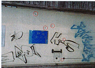
Impacts tirs d'arme à feu sur porte du local transformation
