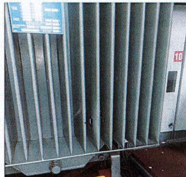
Impacts tirs d'arme à feu sur transformateur
