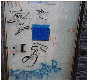
Impacts tirs d'arme à feu sur porte du local transformation
